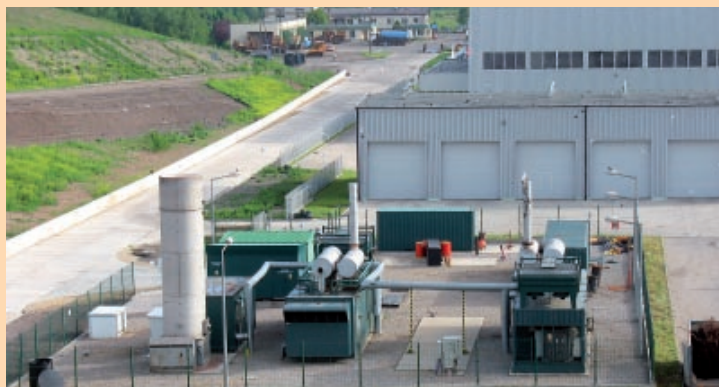
Mała elektrownia biogazowa przy składowisku odpadów komunalnych w Sobuczynie
