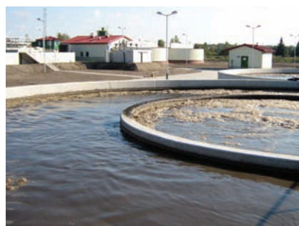
Nowa oczyszczalnia Halemba-Centrum
